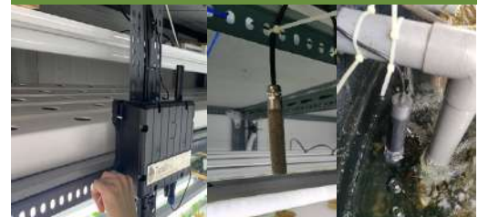
IoT Veggie Kontena
